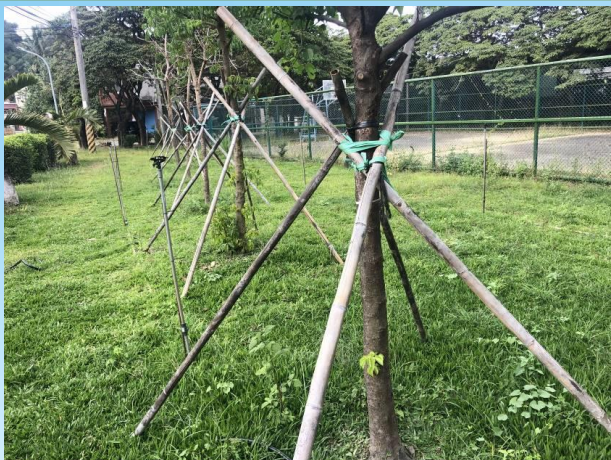
喬木防風支架綁紮方式錯誤
